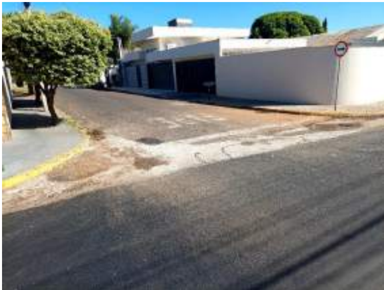
Foto 13 – Sarjetão na Rua Miguel Nucci com Rua Ivai
