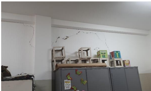
Parede com trincas.
