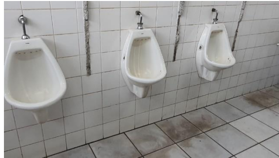
As divisórias do mictório estavam quebradas, e o piso do banheiro estava muito encardido.
