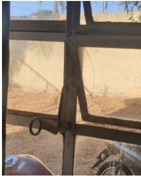
Janela com vidros quebrados.
