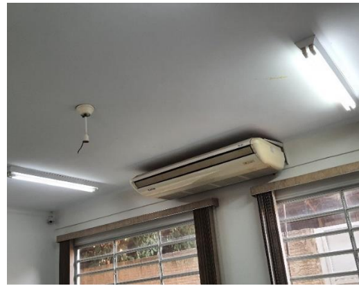
Ventilador quebrado e ar-condicionado inoperante.
