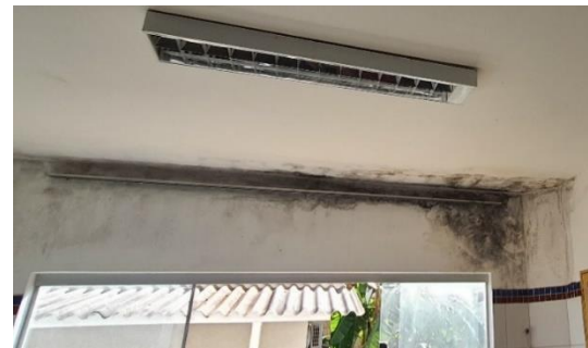
Teto da cozinha com mofo e infiltração.
