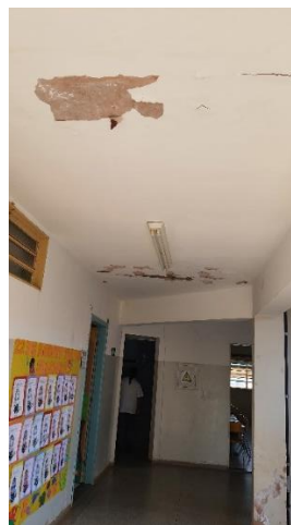
Teto com sinais de infiltração.
