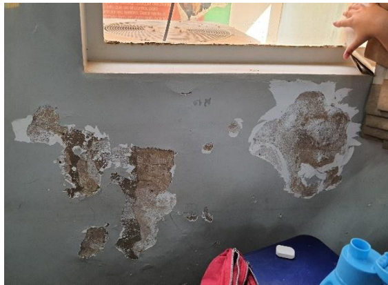
Parede com falhas na pintura.
