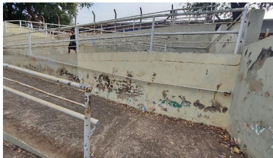
Pintura externa desgastada e com muitas trincas.
