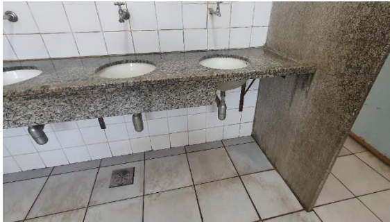
A pedra da pia e estava quebrada.
