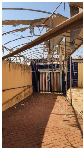
A lona do toldo está totalmente deteriorada.
