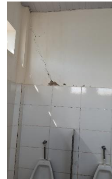
Parede com trincas.
