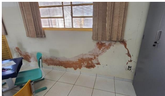
Parede com a pintura desgastada e sinais de infiltração.
