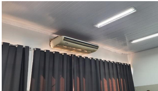
Ares-condicionados das salas 8, 9 e 10 estavam inoperantes.
