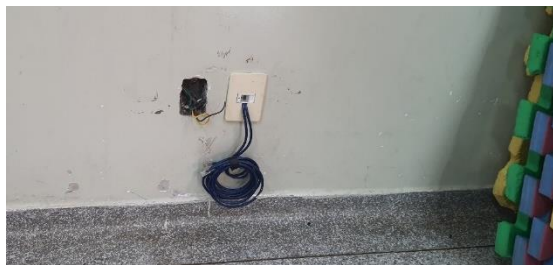
Existência de fios expostos.
