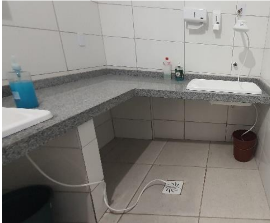
As banheiras são de uso doméstico, inadequadas para banhos sequenciais.
