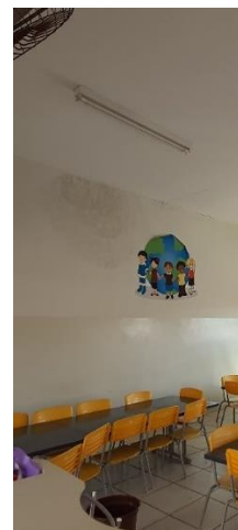
Parede com sinais de infiltração.
