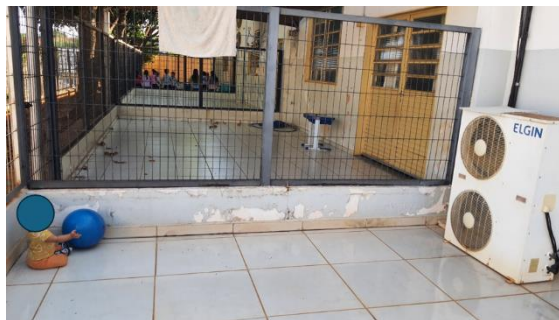
A condensadora do ar-condicionado está instalada em local baixo.
