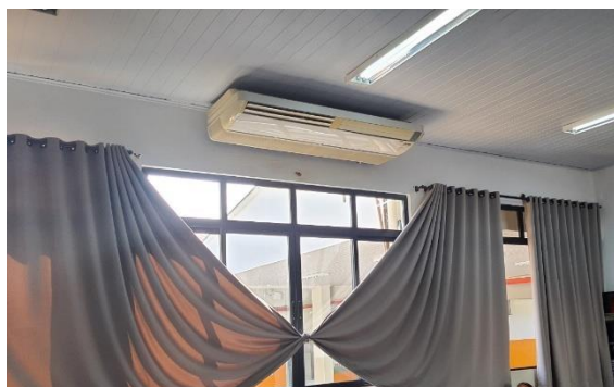
Suporte da cortina da sala 3 estava danificada.
