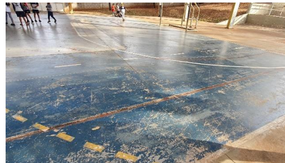
Quadra poliesportiva com pintura desgastada.
