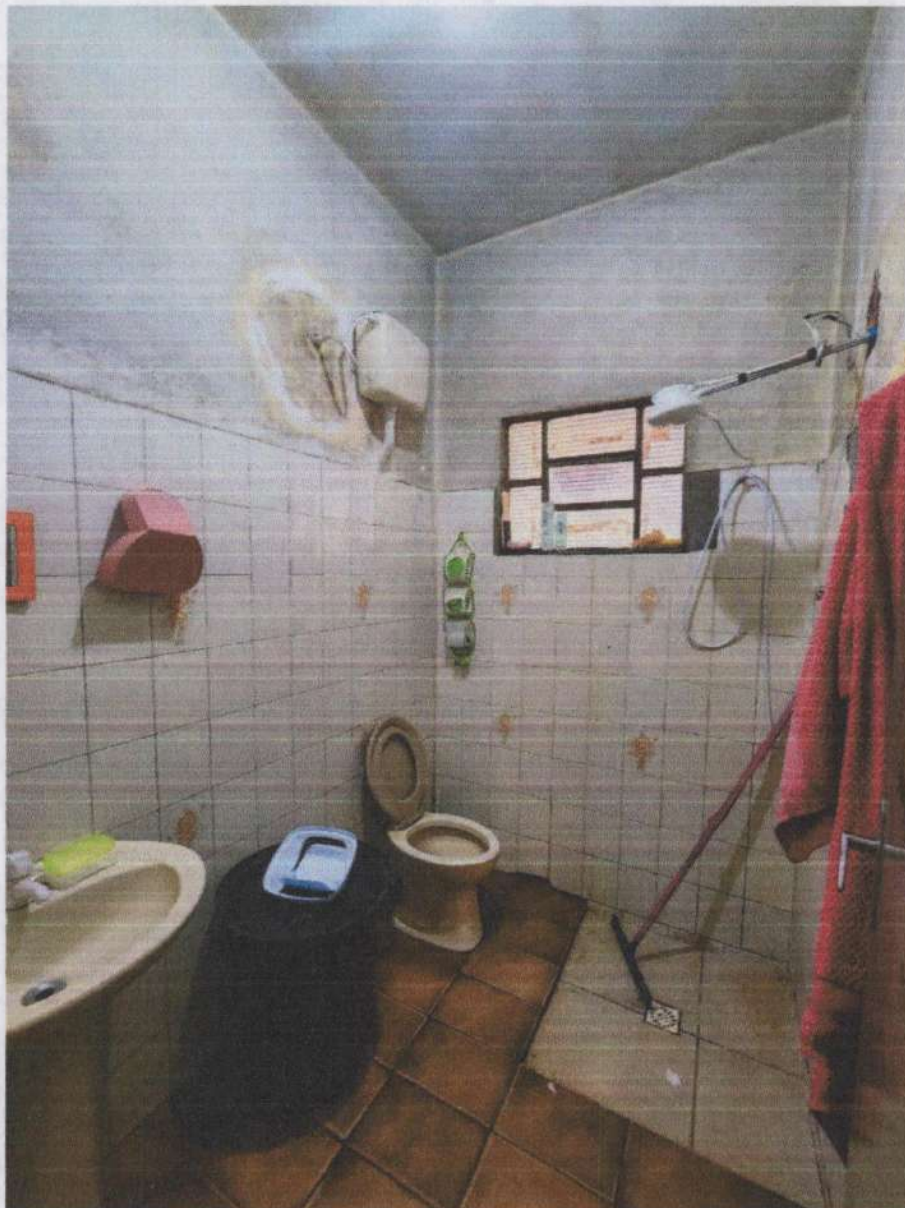
FOTO: 10 –Banheiro com instalações antigas, patologias de infiltração e fiações expostas.
