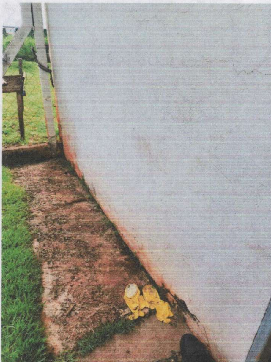
FOTO: 05 – Patologias de infiltrações generalizadas.
