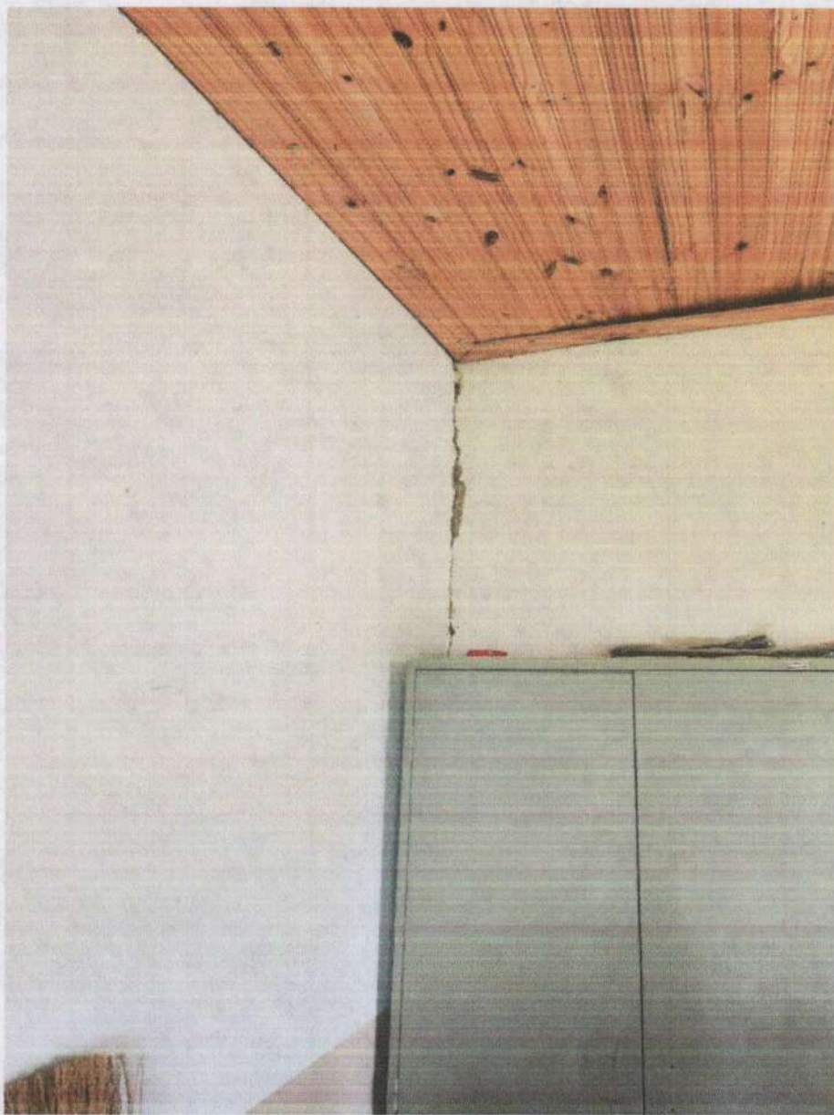
FOTO: 03 - Patologias de rachaduras.
