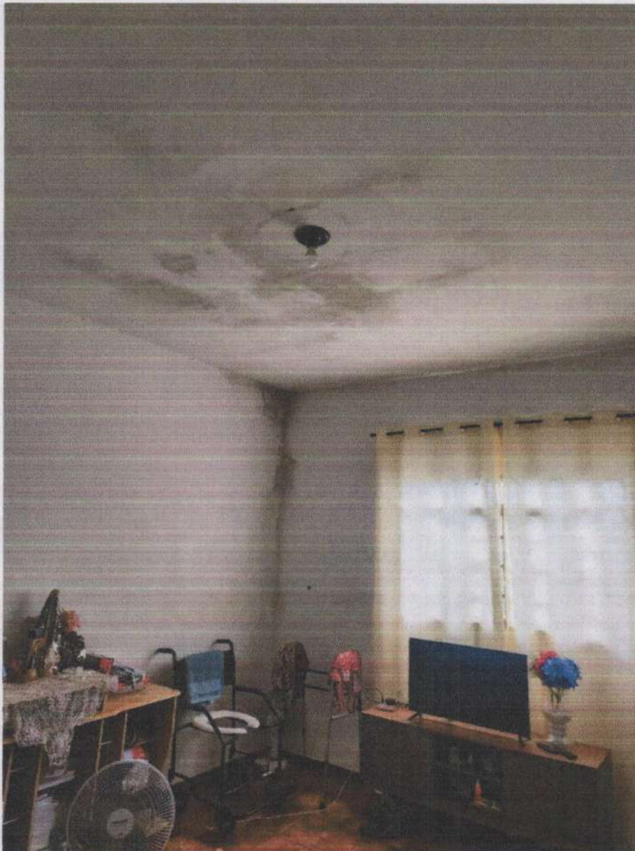
FOTO: 08 – Patologias de infiltração generalizadas.
