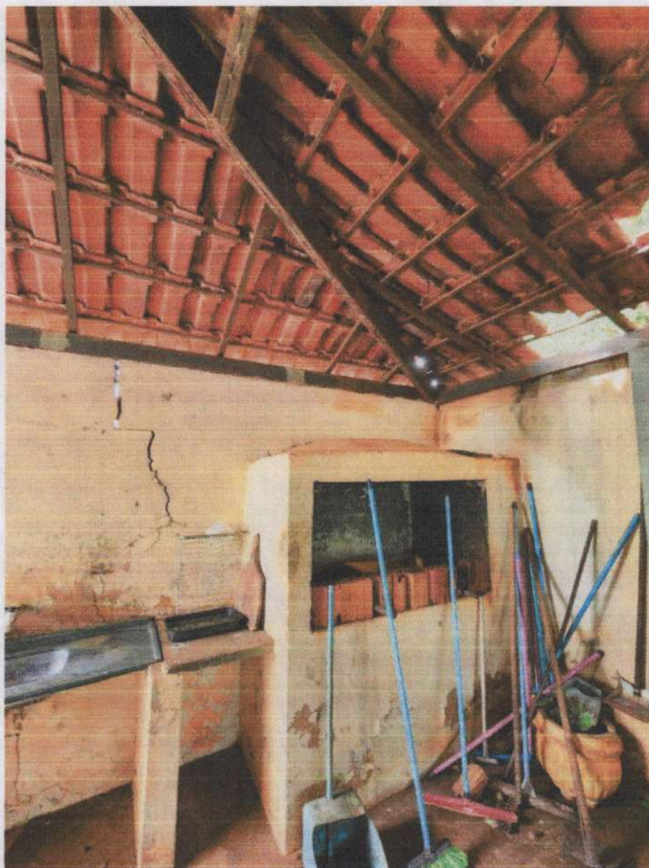
FOTO: 06 - Fissuras e rachaduras aparentes devido a recalques da estrutura, telhado deteriorado, patologias e infiltrações generalizadas, mofo, bolor e ferragens com sinais de oxidação e corrosão.
