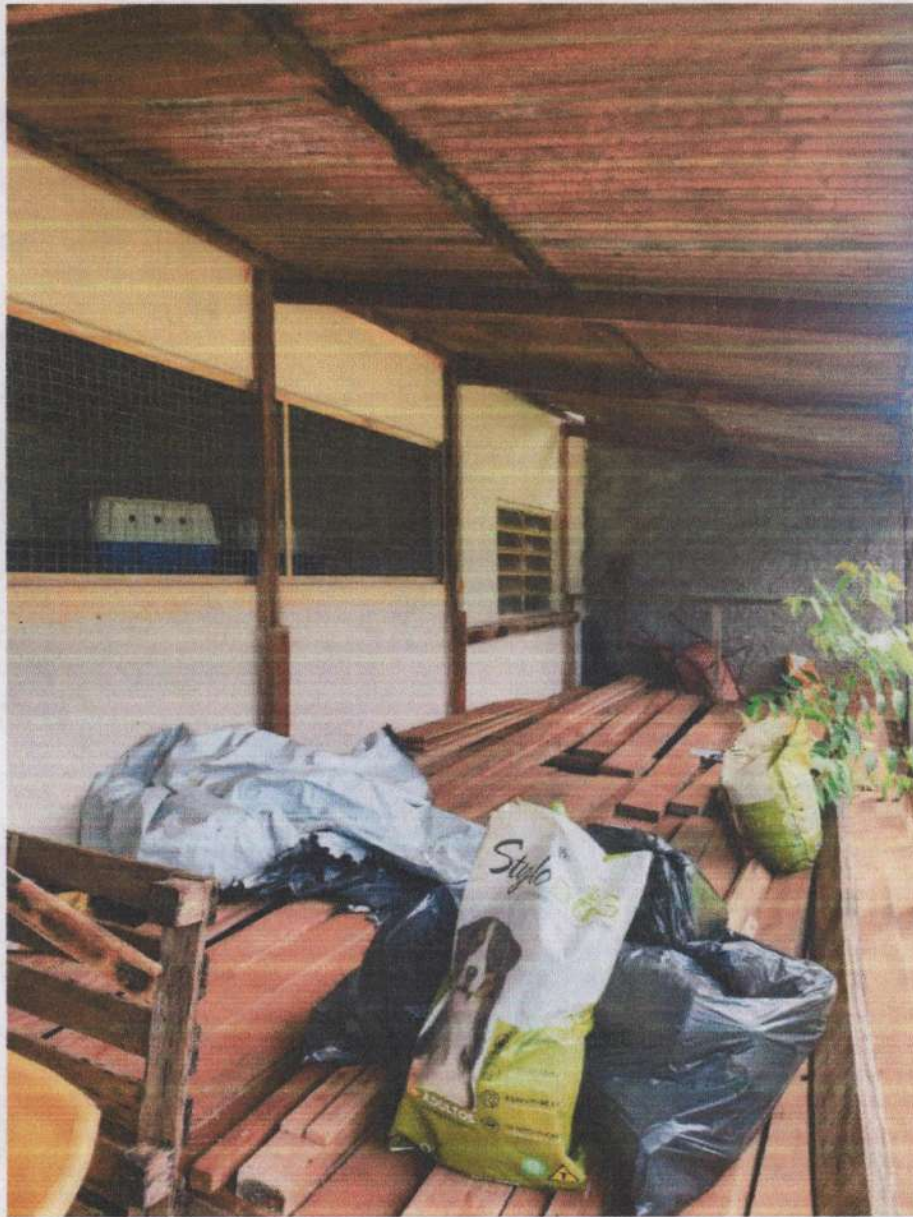
FOTO: 15 - Área externa com acúmulo de materiais, estrutura de madeira deteriorada, instalada incorretamente e instalações antigas.
