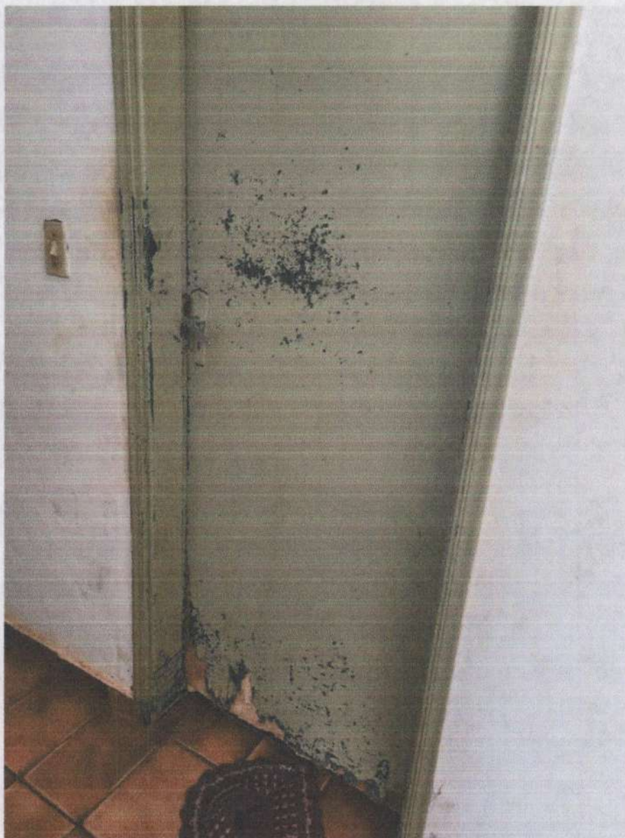
FOTO: 09 – Patologias de infiltrações generalizadas, porta de madeira danificada e instalações antigas.
