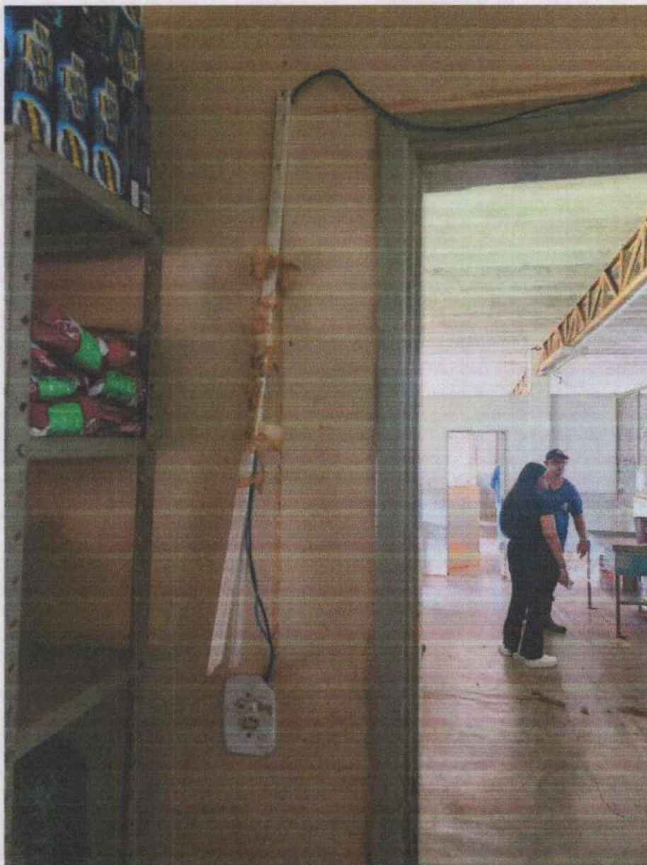
FOTO: 09 – Instalação elétrica exposta com caneleta danificada.
