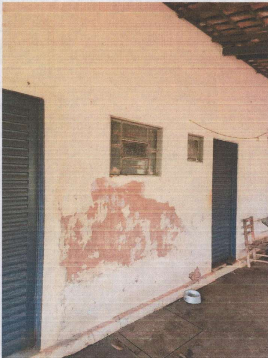
FOTO: 05 – Patologias de infiltrações generalizadas, instalações antigas e contrapiso deteriorado.
