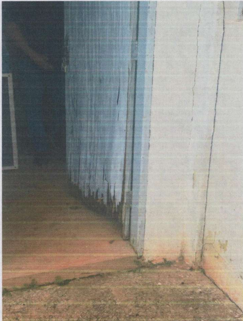
FOTO: 19 – Porta de madeira danificada, danos estruturais e desnível entre pisos.
