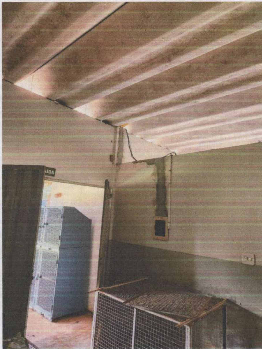
FOTO: 14 – Aberturas na estrutura, falta de vedação em ambiente externo e fios elétricos expostos.
