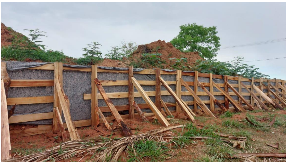
Figura 38 – Descarte da material da represa e finalização da paliçada (Foto tirada pelo Fiscal da Obra)
