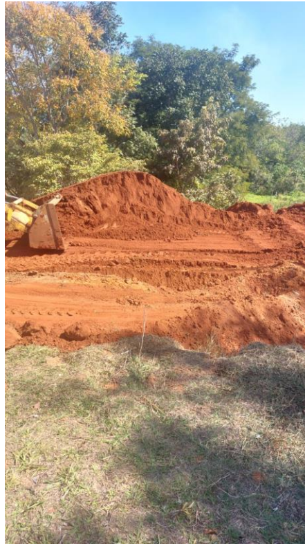
Figura 2 – Construção de rampa de acesso a represa (Foto tirada pelo Fiscal da Obra)
