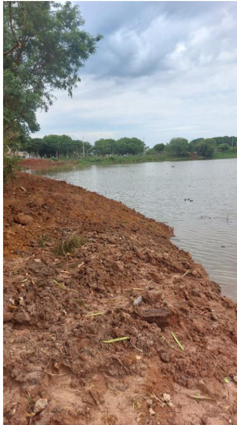
Figura 41 – Término da retirada de barro da represa. (Foto tirada pelo Fiscal da Obra)
