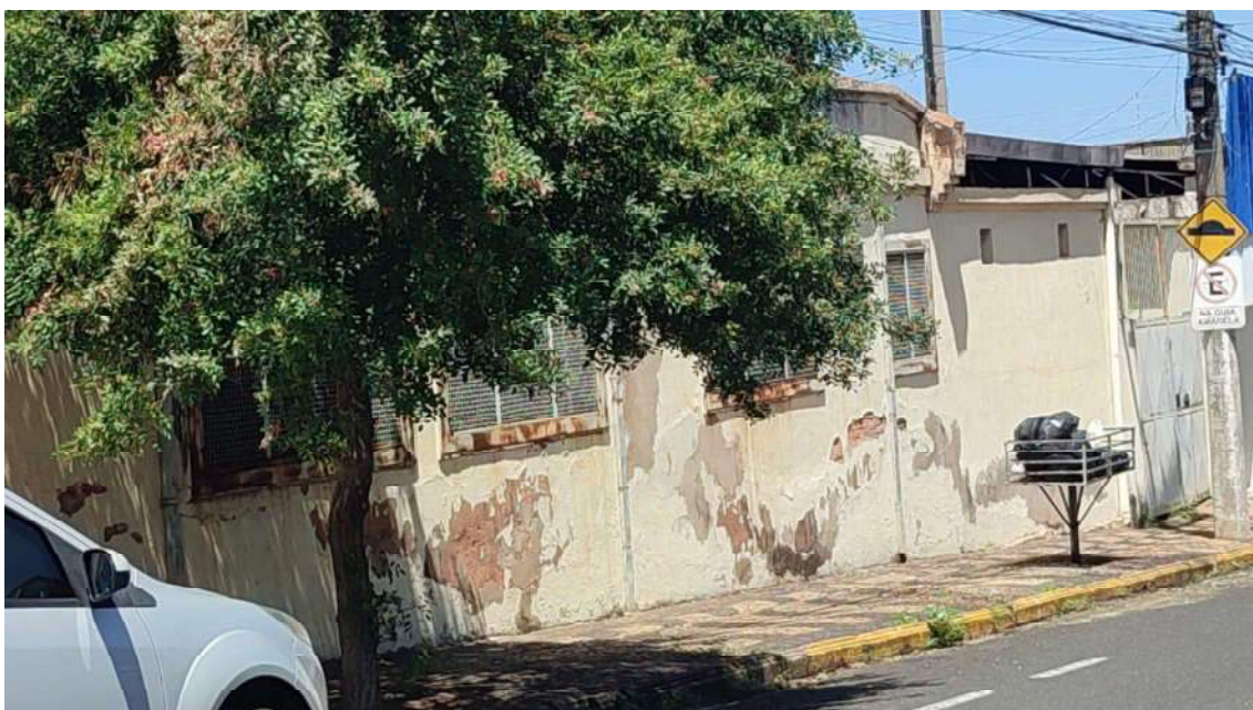
FOTO: 24 - Rua Pe. Izidoro Cordeiro Paranhos, infiltrações e instalações precárias.
