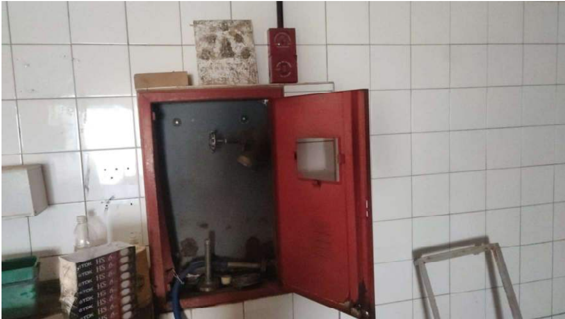
FOTO: 21 - Sistema de combate a incêndio desativados e instalações antigas.
