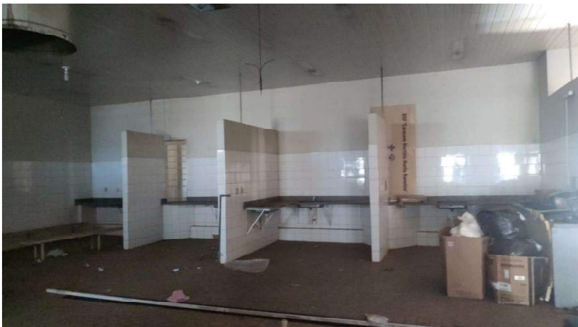
FOTO: 20 - Divisões em alvenarias, forros danificados e instalações antigas.
