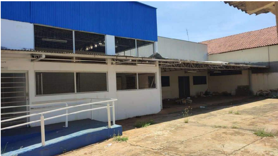
FOTO: 12 - Estruturas metálicas "PUXADINHOS" danificados.
