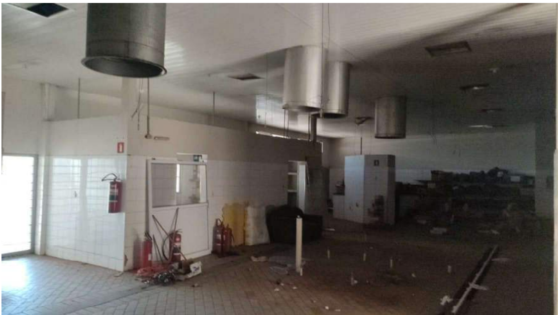
FOTO: 22 - Sistema de coifas desativadas, grelhas internas e instalações antigas.
