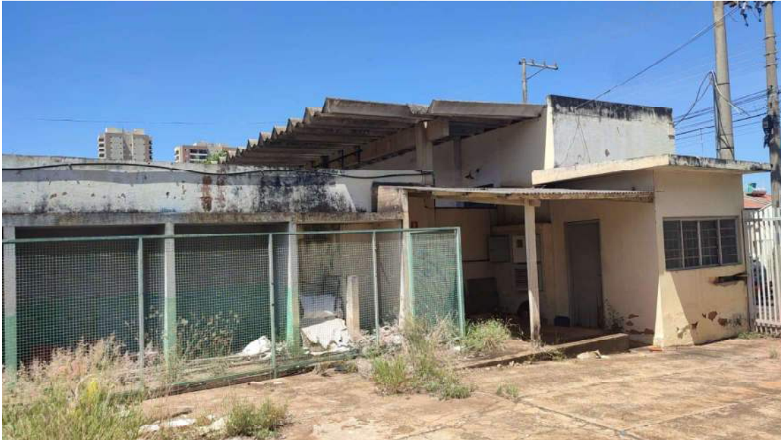
FOTO: 13 - Redes elétricas de alimentação destruídas.
