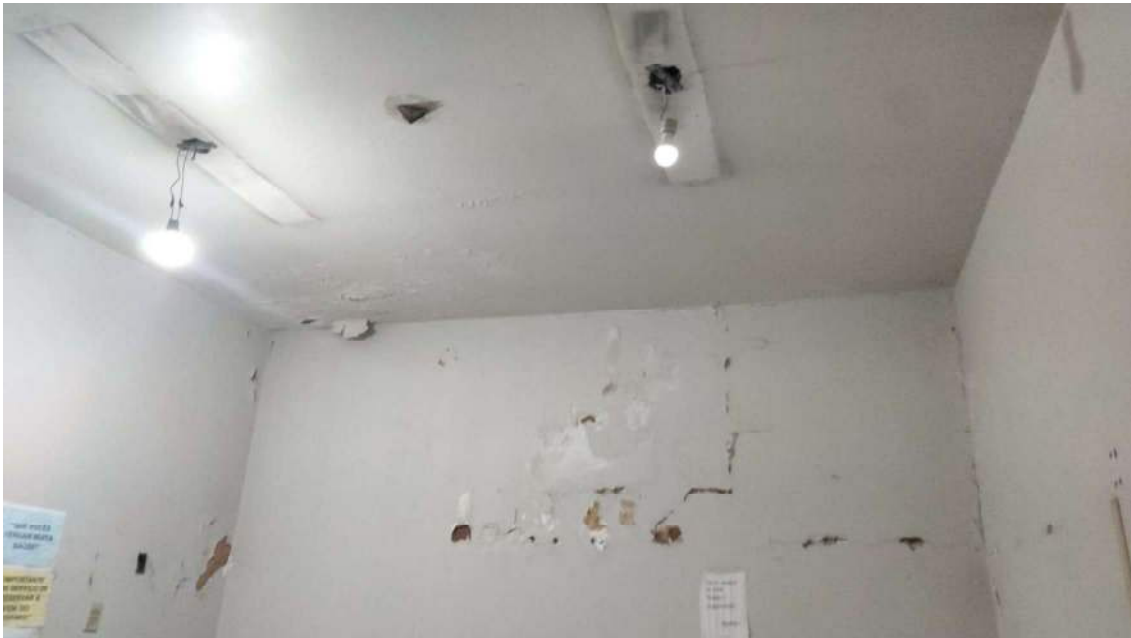
FOTO: 08 - Patologias de Infiltrações generalizadas.
