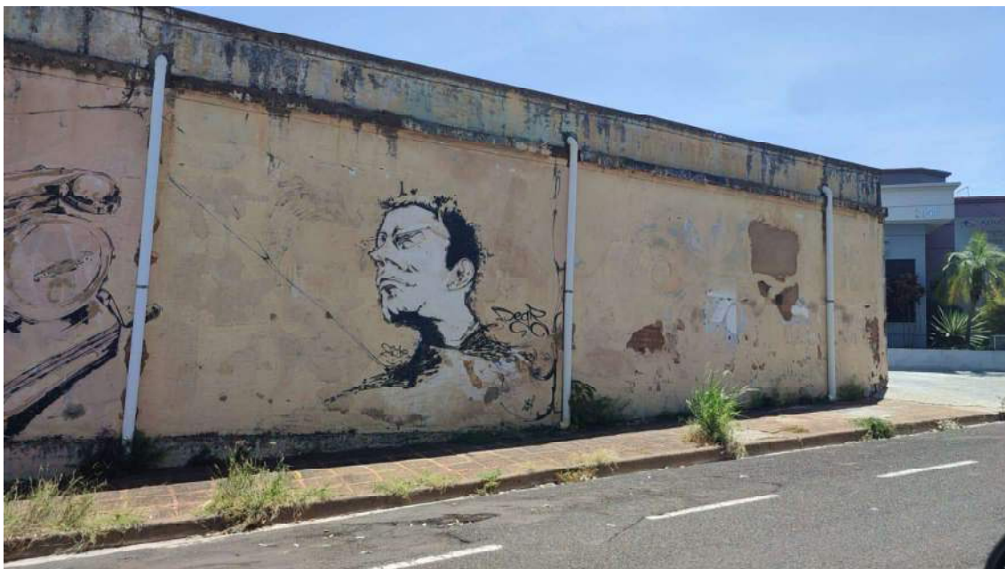
FOTO: 23 - Rua Alagoas drenos de águas pluviais externos e instalações precárias.
