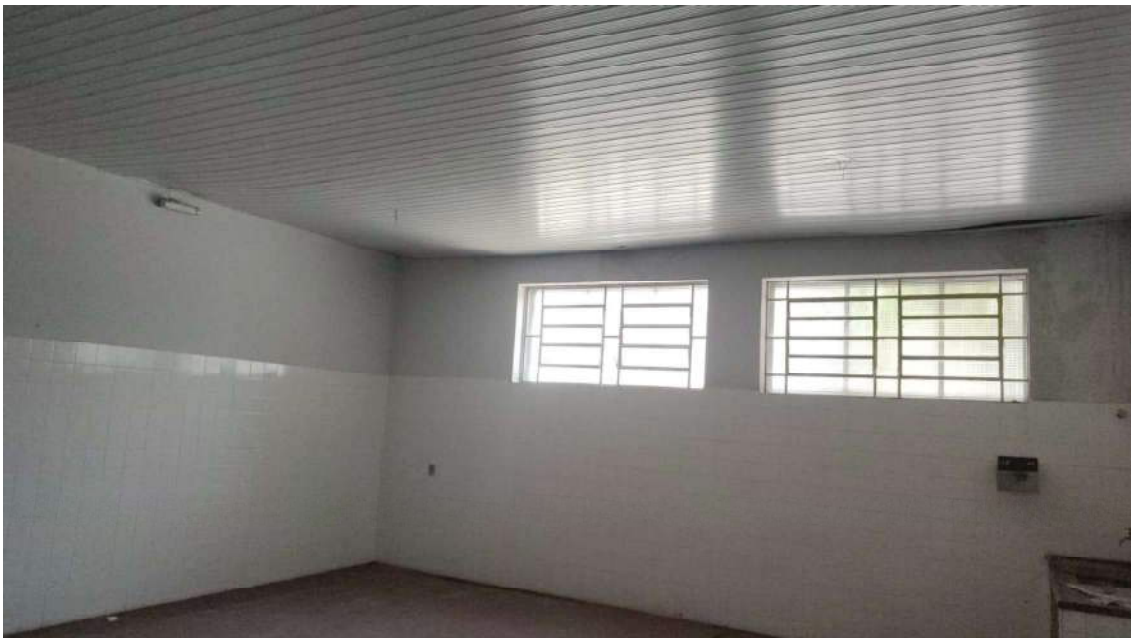
FOTO: 14 - Forro pvc selado, piso e instalações antigas.
