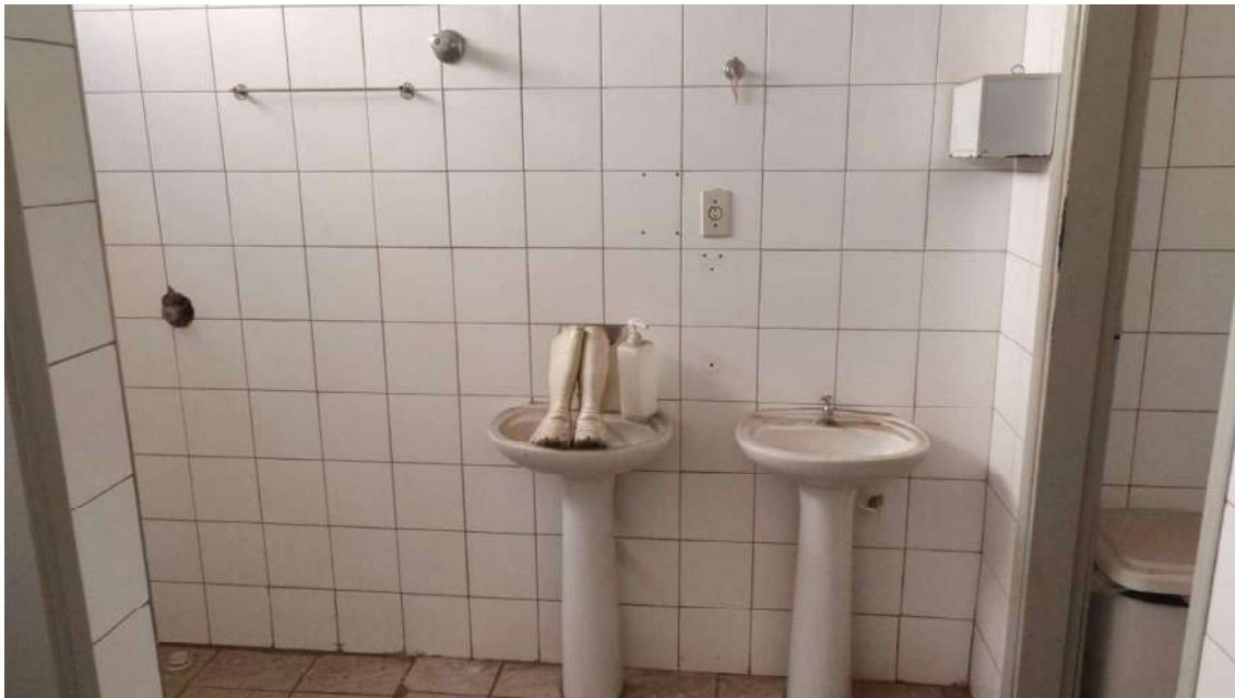
FOTO: 17 - Sanitários precários, instalações antigas.
