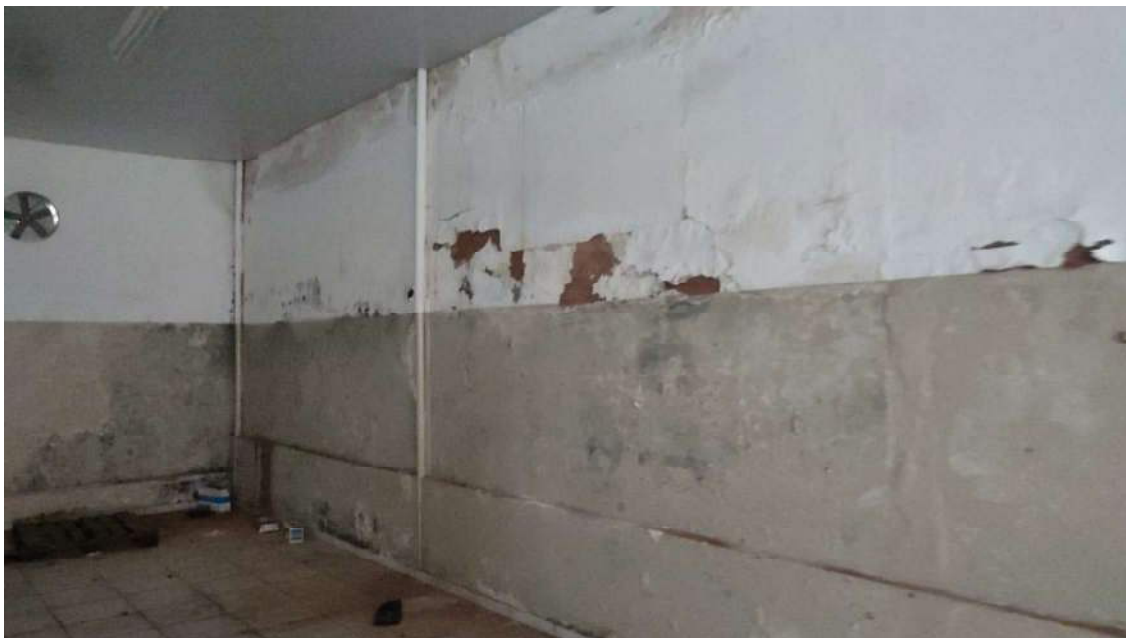
FOTO: 15 - Patologias de Infiltrações generalizadas.
