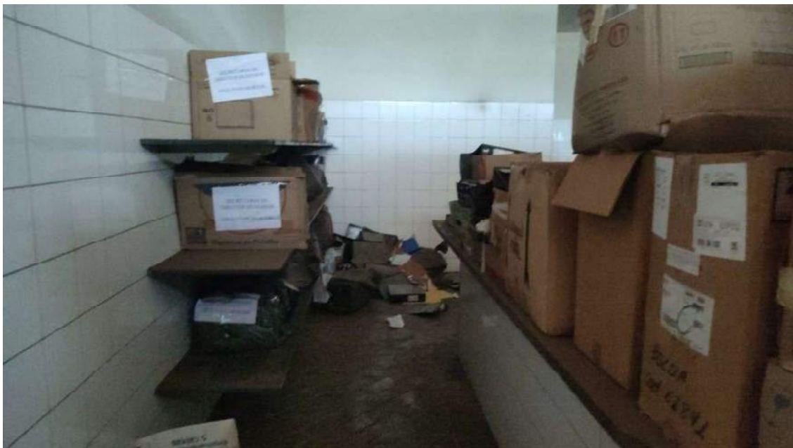
FOTO: 19 - Bancadas e prateleiras obsoletas, instalações antigas.
