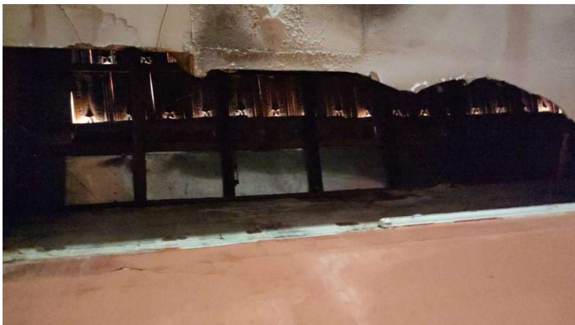
FOTO: 06 - Gesso acartonado deslocando.
