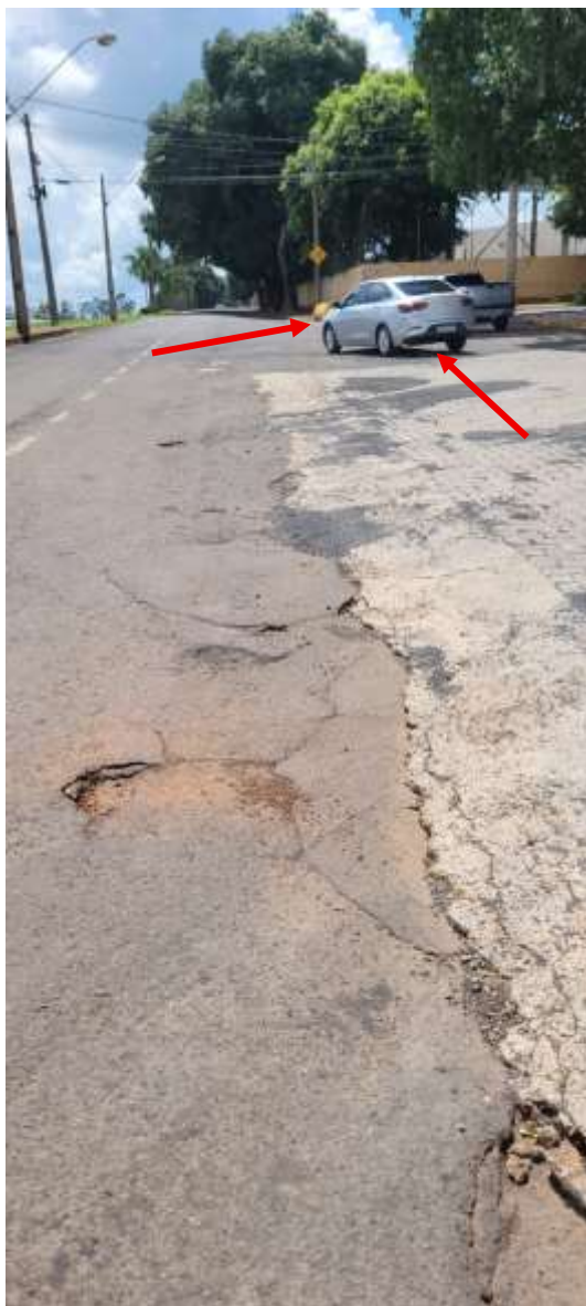
Conflito na saída de veículos
