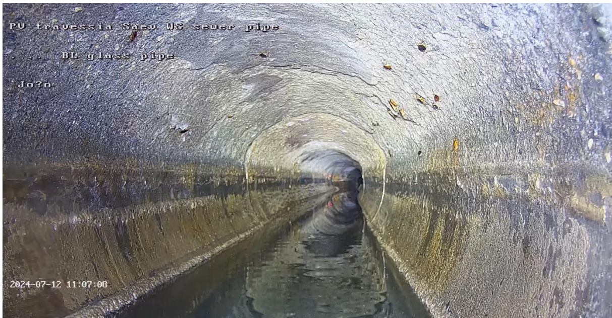
Figura 2: Trecho a jusante da possível obstrução (baixa vazão do esgoto).
