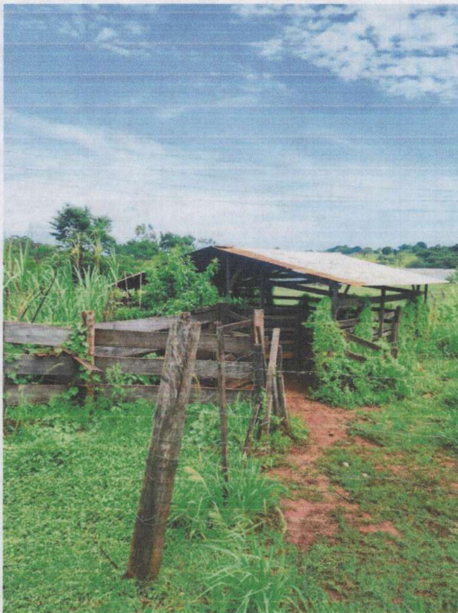
FOTO: 08 - Estrutura em condições precárias, com cercamento danificado e risco de colápsio.
