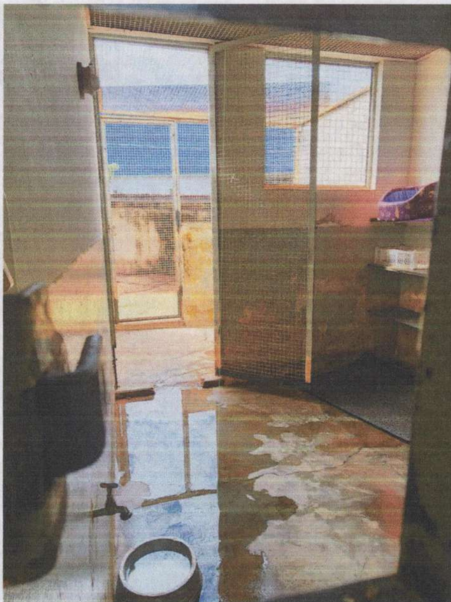
FOTO: 20 -Patologias diversas de infiltração, acúmulo de água no piso, instalações antigas e estrutura metálica com oxidações e corrosões.
