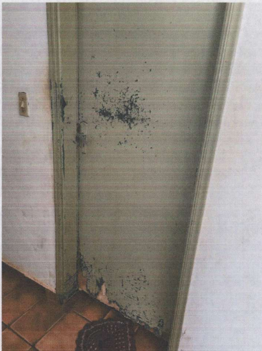
FOTO: 09 – Patologias de infiltrações generalizadas, porta de madeira danificada e instalações antigas.
