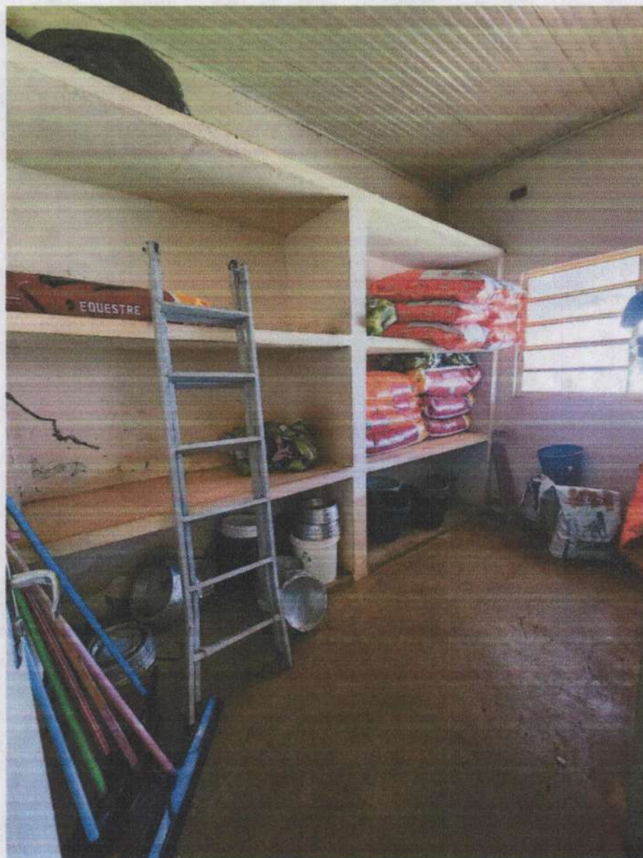
FOTO: 13 – Prateleiras obsoletas, instalações antigas e patologias de infiltração.
