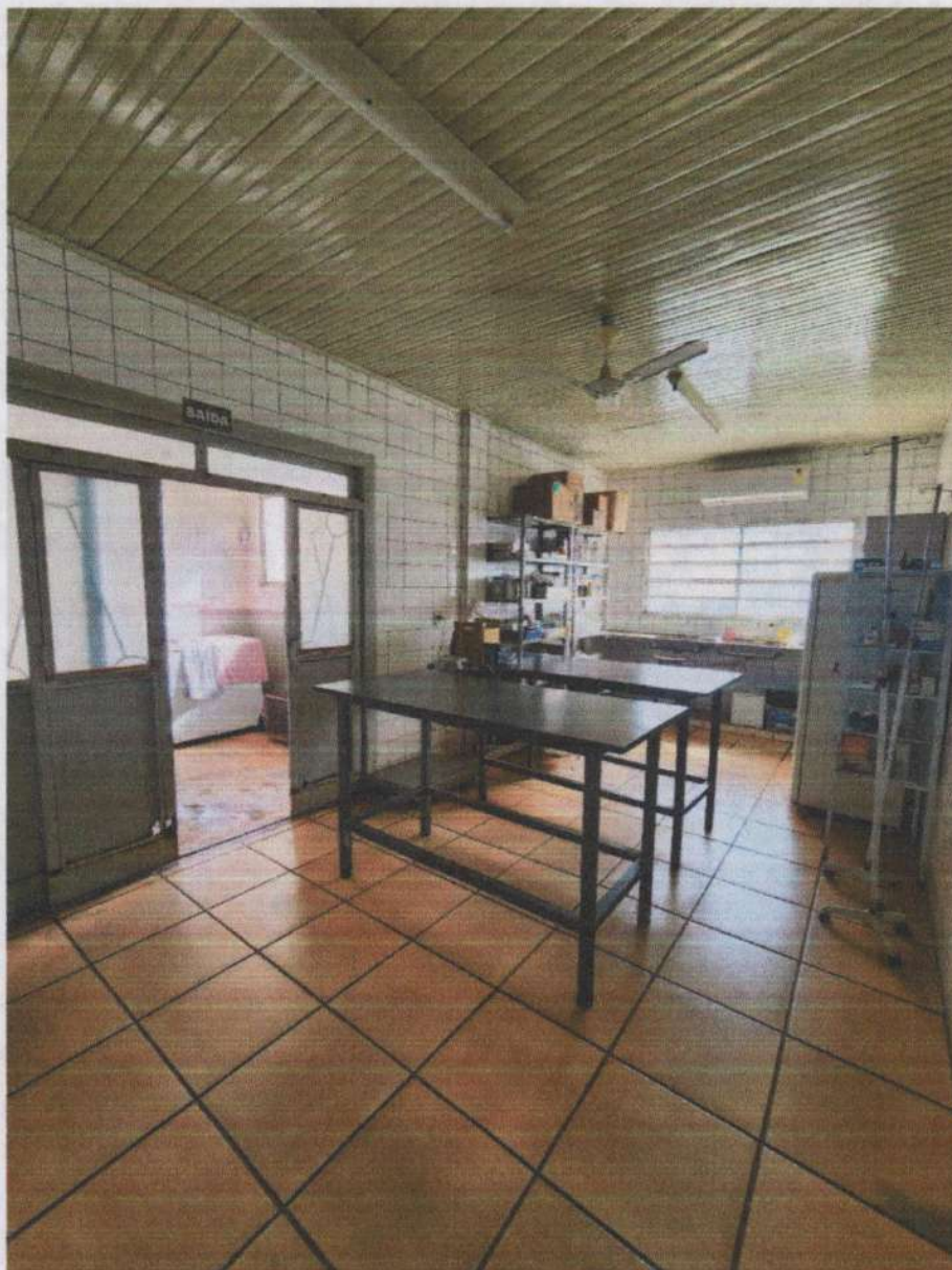
FOTO: 21 – Porta com sinais de oxidação e corrosão, ambiente precário e instalações antigas.
