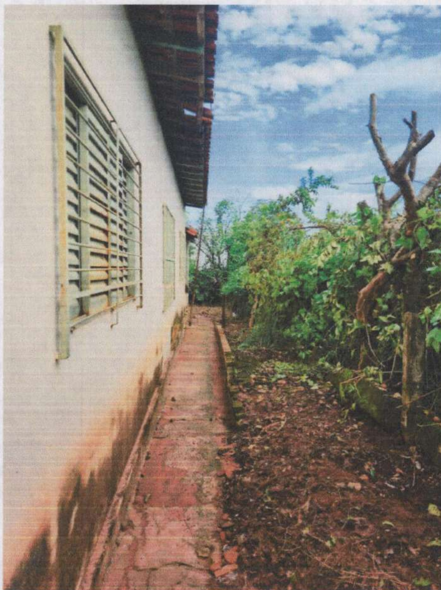
FOTO: 12 – Patologias de infiltração, mofo e bolor, telhado e calçamento externo danificados.
