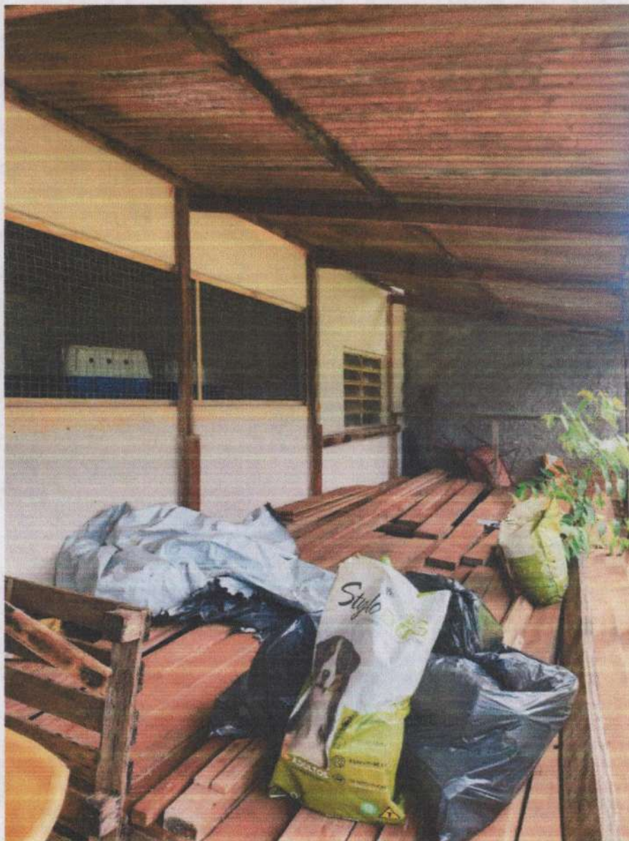
FOTO: 15 - Área externa com acúmulo de materiais, estrutura de madeira deteriorada, instalada incorretamente e instalações antigas.
