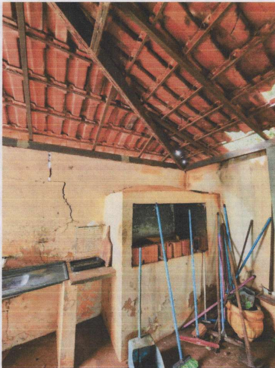
FOTO: 06 - Fissuras e rachaduras aparentes devido a recalques da estrutura, telhado deteriorado, patologias e infiltrações generalizadas, mofo, bolor e ferragens com sinais de oxidação e corrosão.
