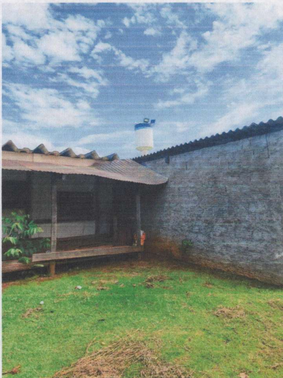
FOTO: 16 -Área externa com cobertura danificada com risco de colapso, estrutura de madeira danificada e instalações antigas.
