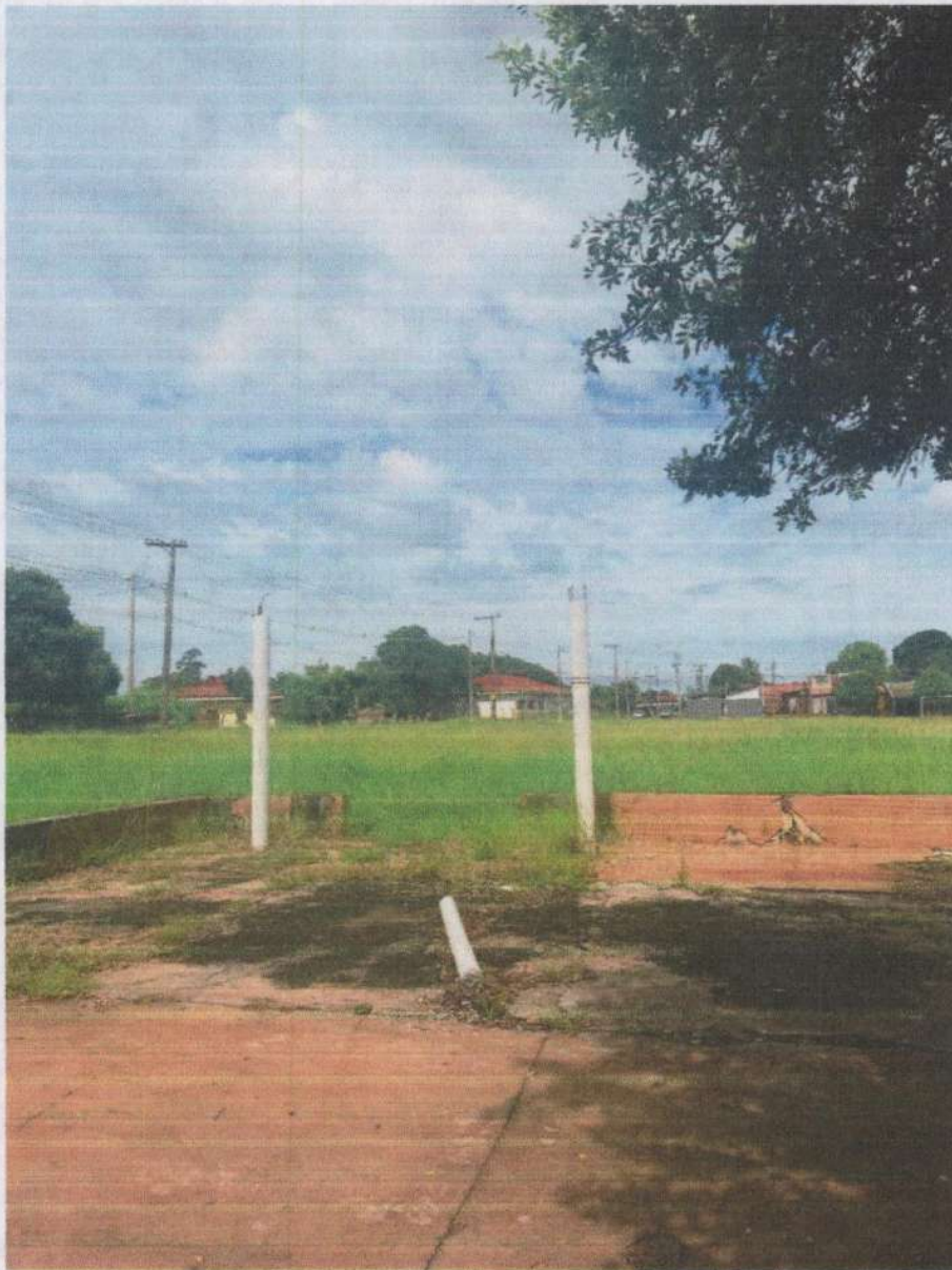
FOTO: 18 – Área externa com piso deteriorado, pilar caído e outros com risco de colapso.
