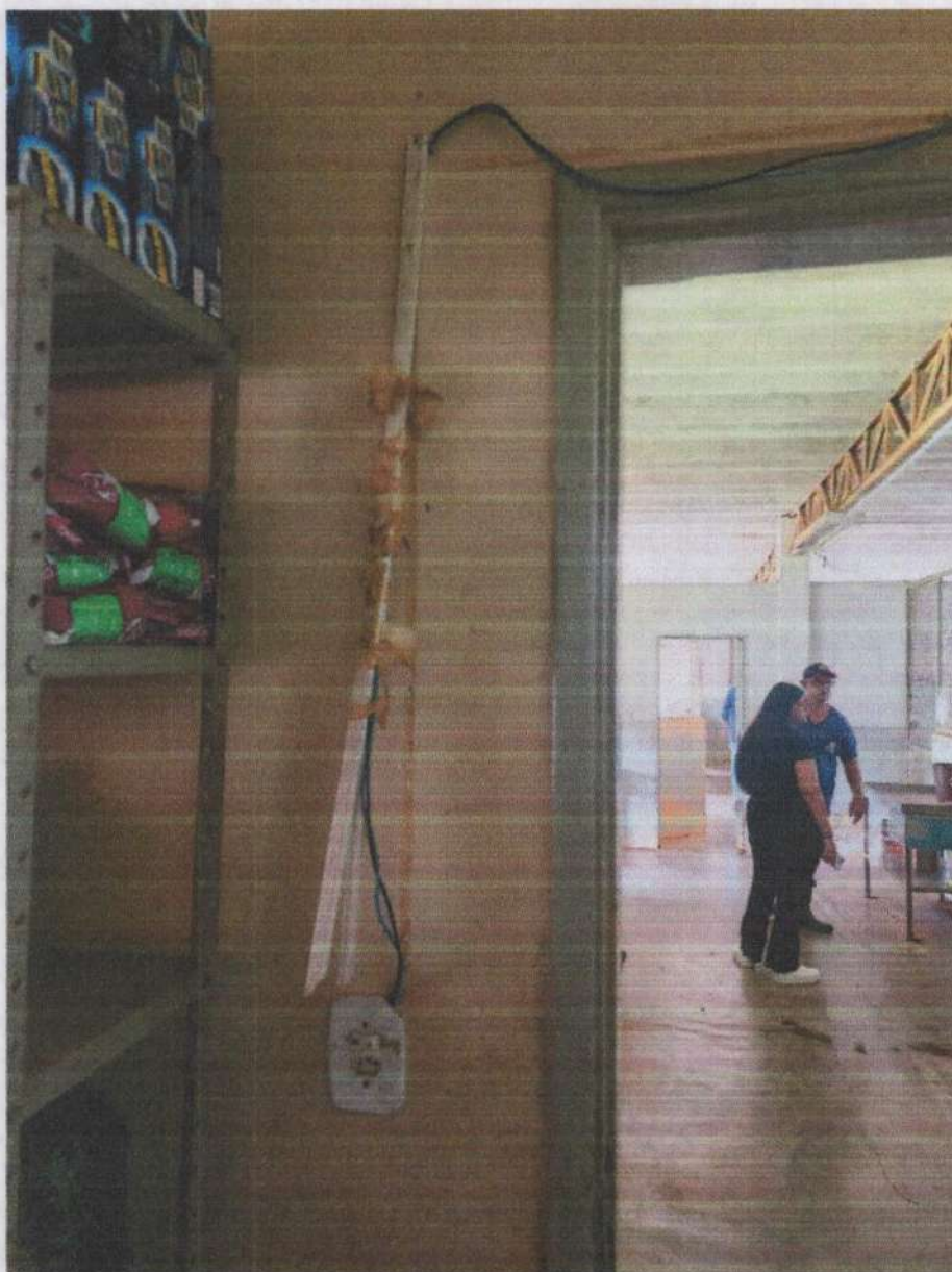
FOTO: 09 – Instalação elétrica exposta com caneleta danificada.
