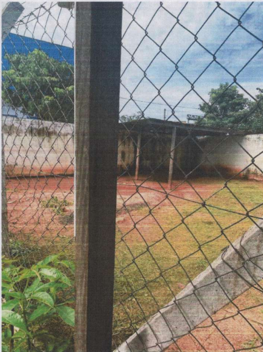
FOTO: 17 -Patologias diversas de infiltração e estrutura danificada com risco de colapso.
