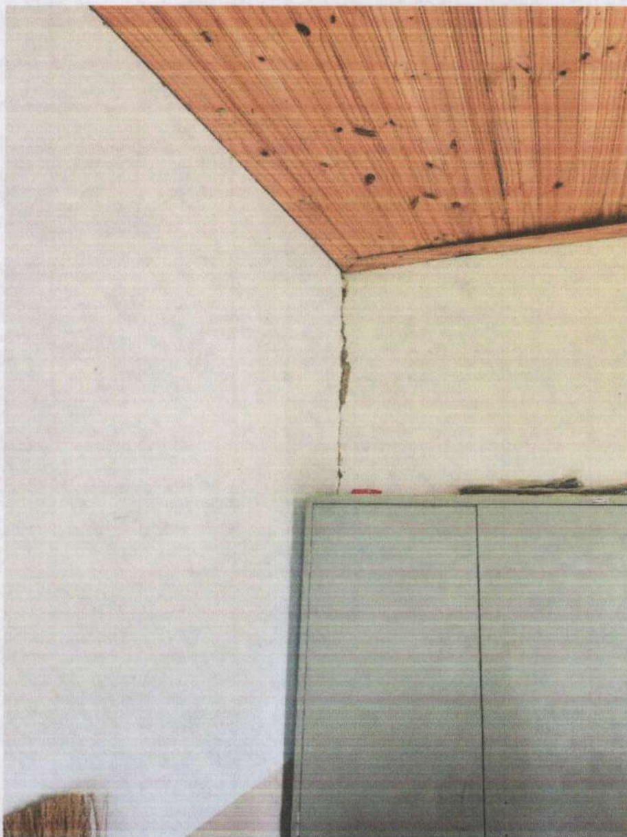
FOTO: 03 - Patologias de rachaduras.
