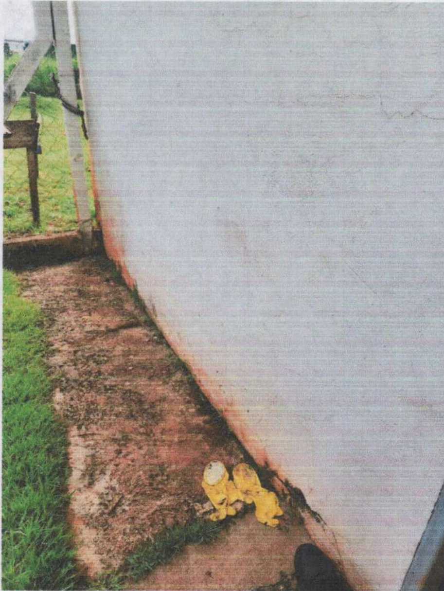
FOTO: 05 – Patologias de infiltrações generalizadas.
