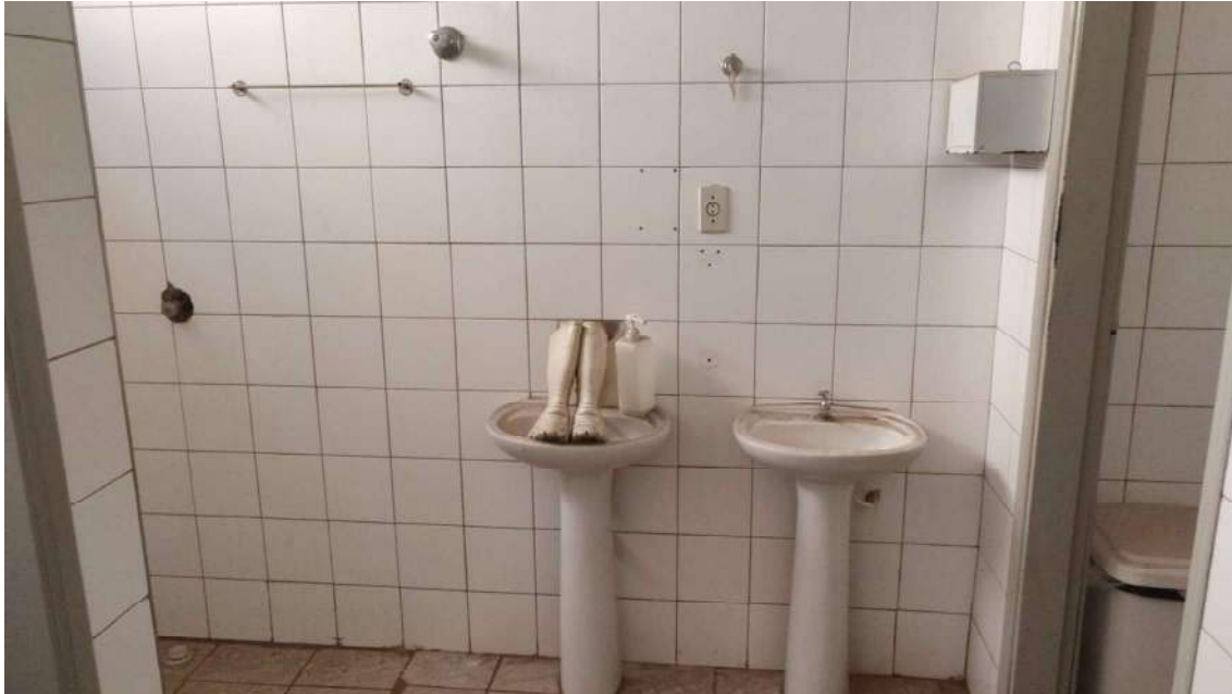
FOTO: 17 - Sanitários precários, instalações antigas.
