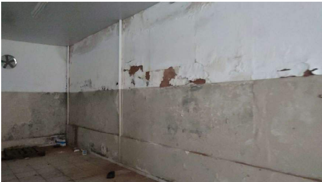
FOTO: 15 - Patologias de Infiltrações generalizadas.
