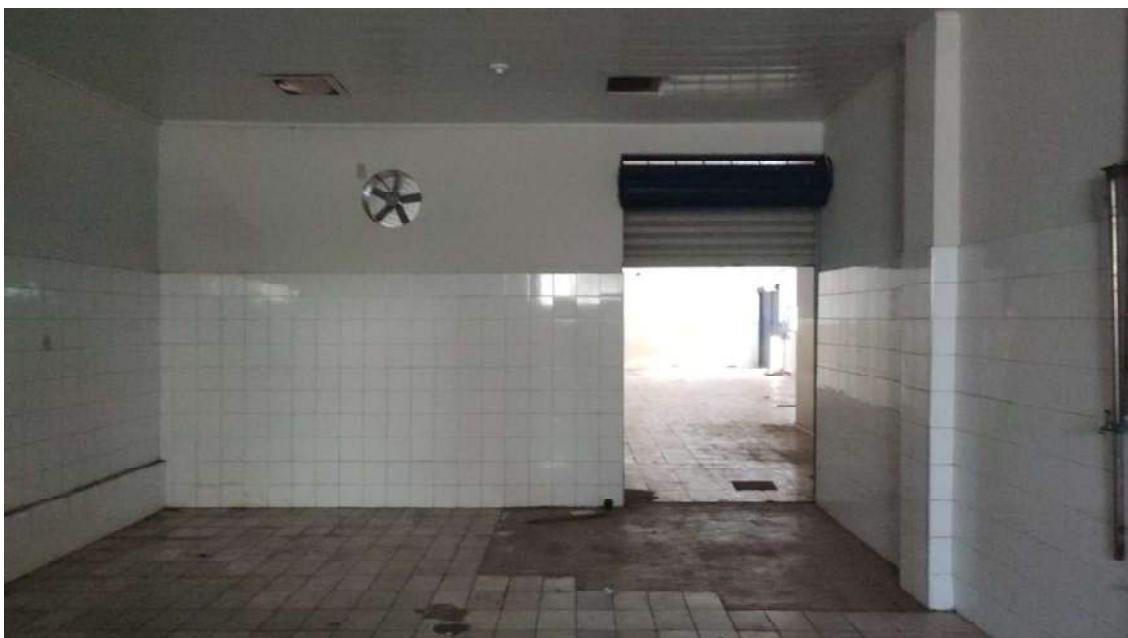
FOTO: 16 - Forro pvc e pisos degradados, instalações antigas.
