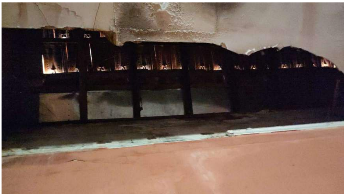
FOTO: 06 - Gesso acartonado deslocando.
