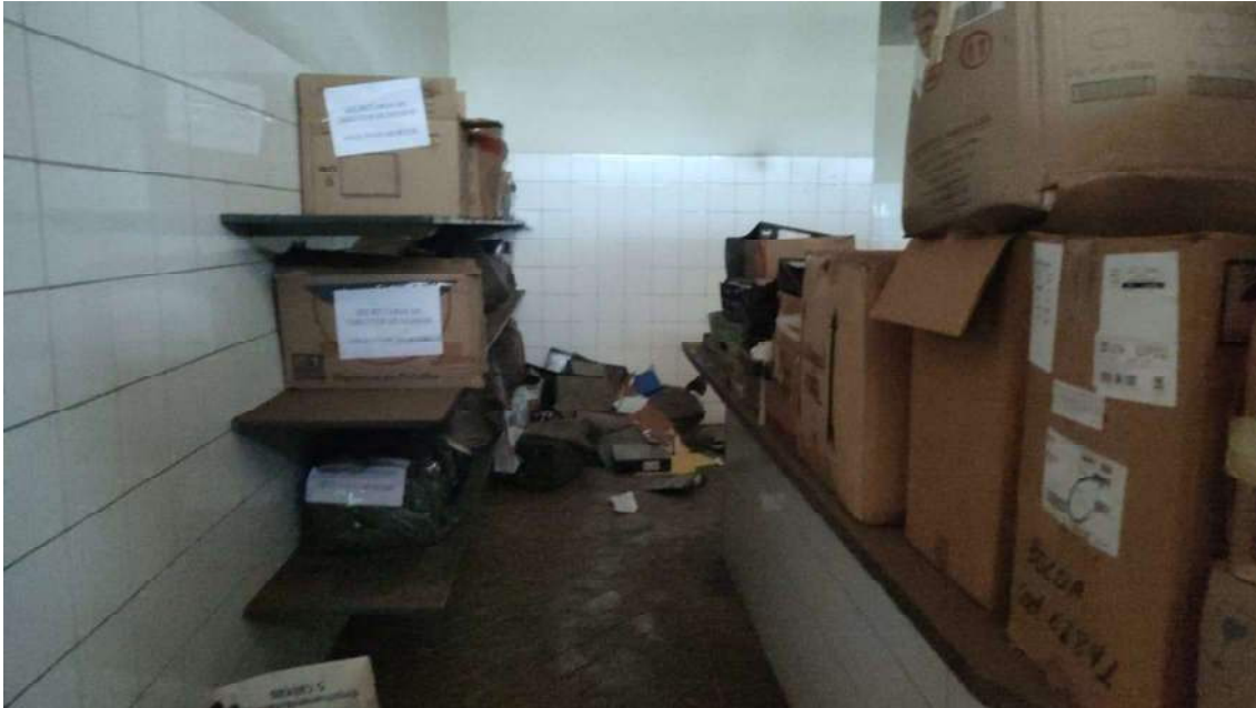
FOTO: 19 - Bancadas e prateleiras obsoletas, instalações antigas.
