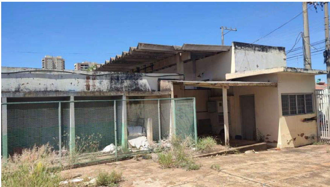
FOTO: 13 - Redes elétricas de alimentação destruídas.
