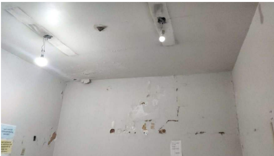
FOTO: 08 - Patologias de Infiltrações generalizadas.
