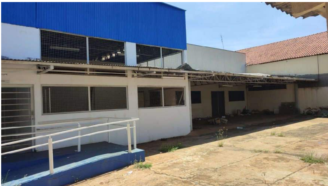
FOTO: 12 - Estruturas metálicas "PUXADINHOS" danificados.
