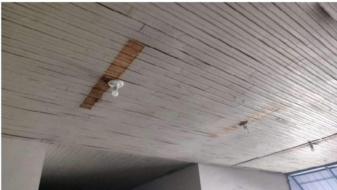
FOTO: 07 - Forro de madeira empenado e com dilatações.
