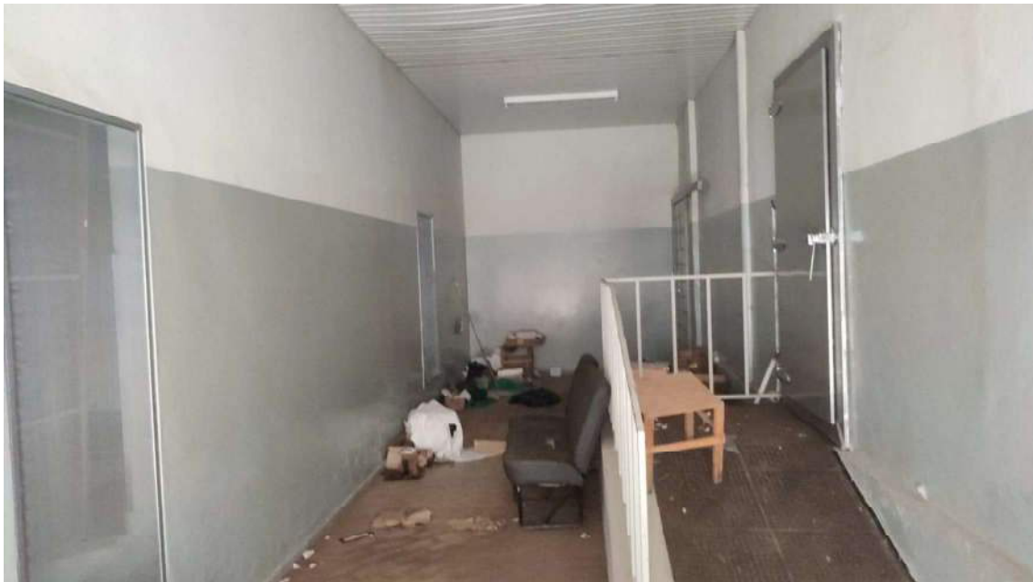
FOTO: 18 - Câmara frigorífica desativada, desníveis e instalações antigas.
