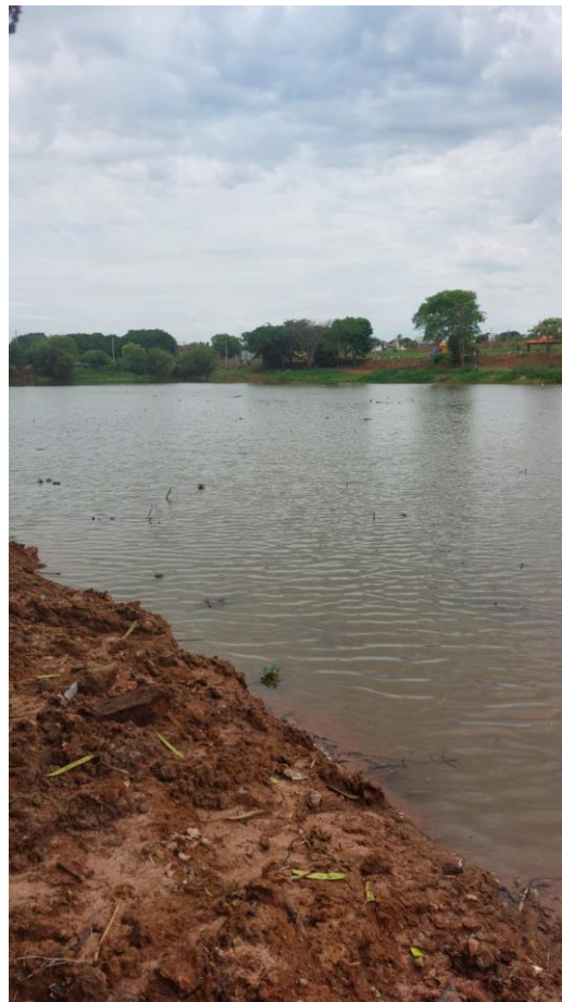
Figura 40 – Término da retirada de barro da represa. (Foto tirada pelo Fiscal da Obra)
