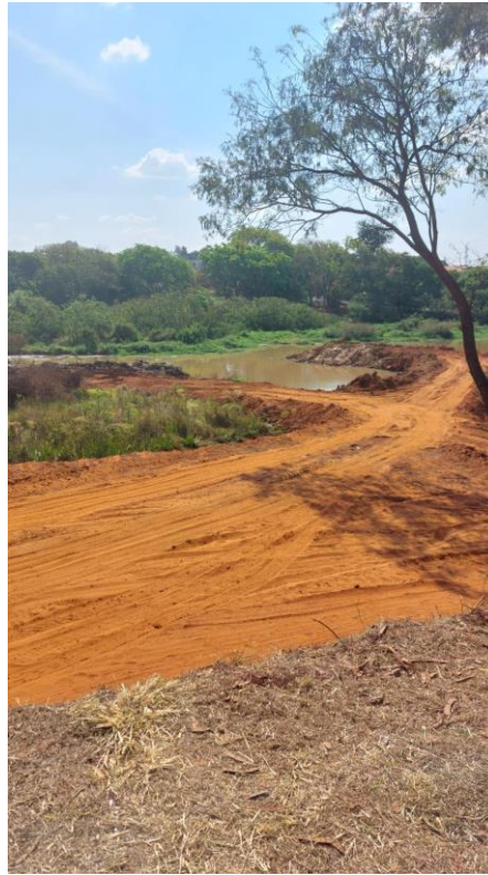
Figura 23 – retirada do barro e fazendo caminhos na represa para acesso (Foto tirada pelo Fiscal da Obra)
